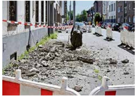
Am Wochenende sind erneut Teile der Fassade herausgebrochen. Foto: Dirk Jochmann
